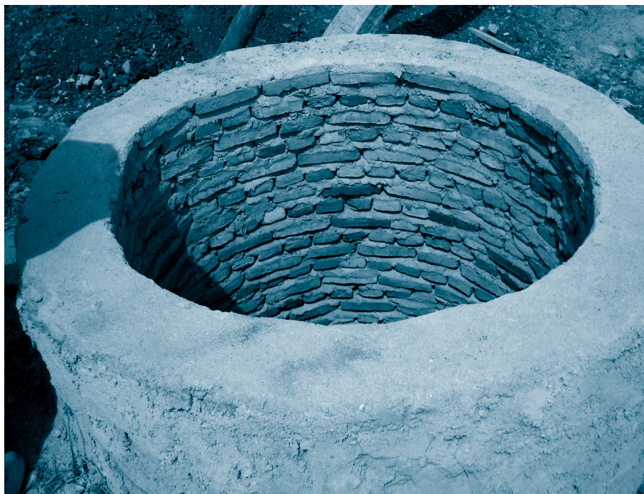
Premier puits de déversement des eaux usées dans un nouveau quartier urbanisé de Bujumbura.
