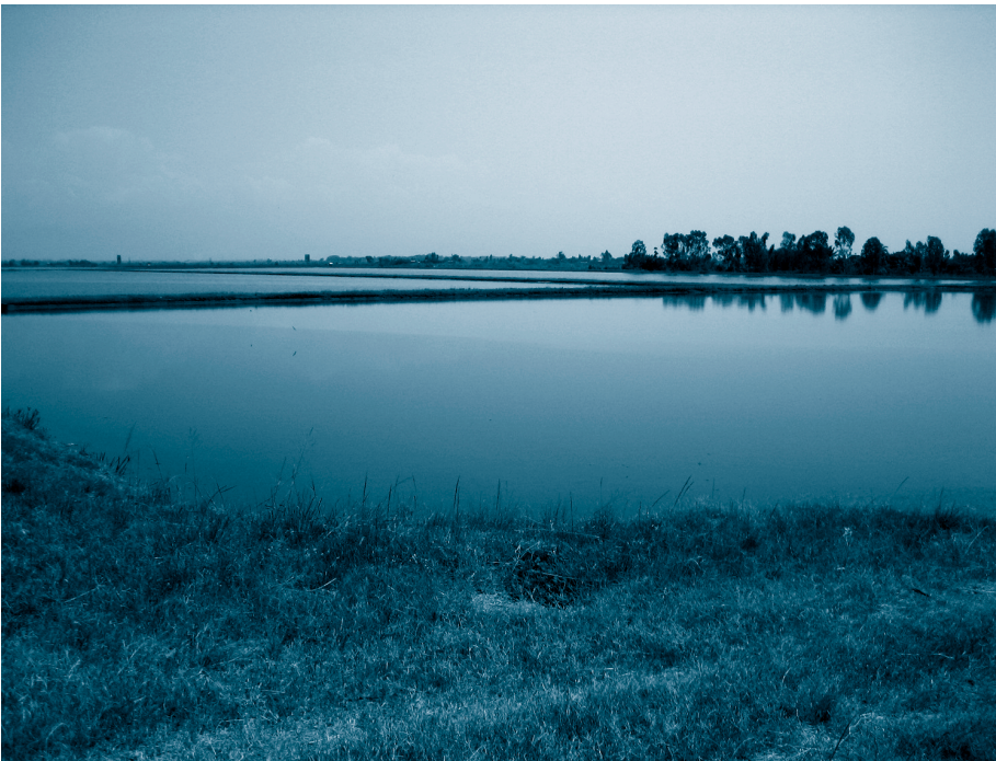
Étangs de la station d'épuration de Bujumbura.
