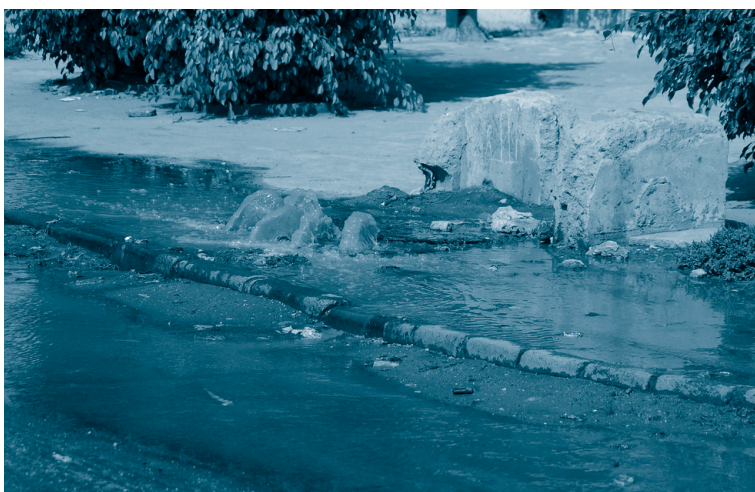
Problème de maintenance à Dakar
