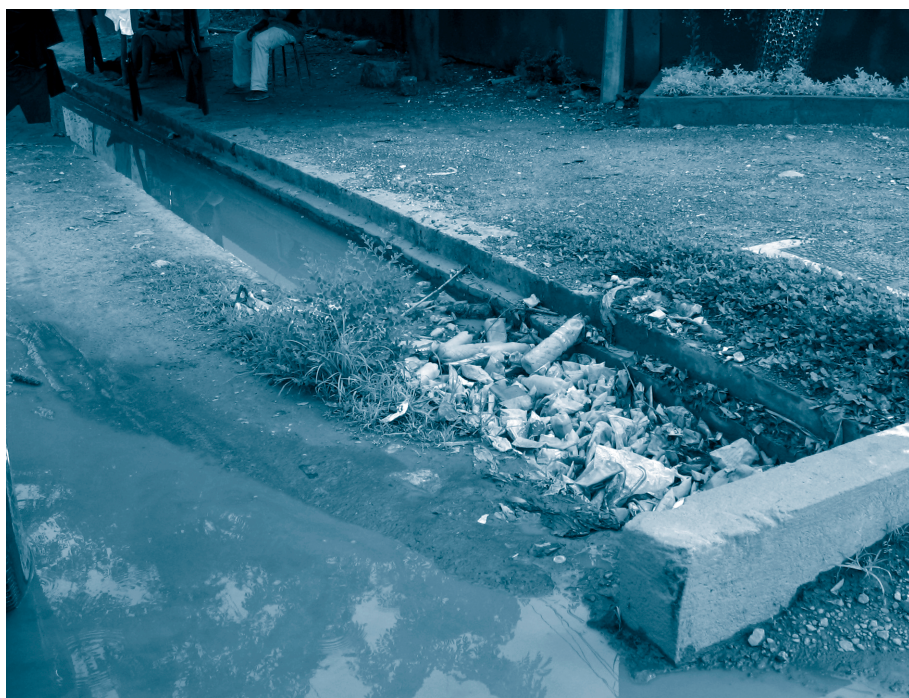
Caniveau d'évacuation bouché d'ordures à Ouagadougou.
